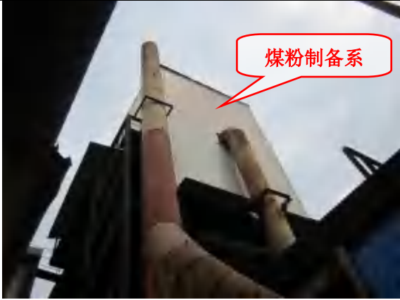
煤粉制备系统
